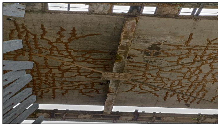
Gambar 3. Retakan Lantai Jembatan
