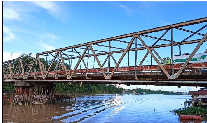
Gambar 2. Korosi Rangka Baja Jembatan
