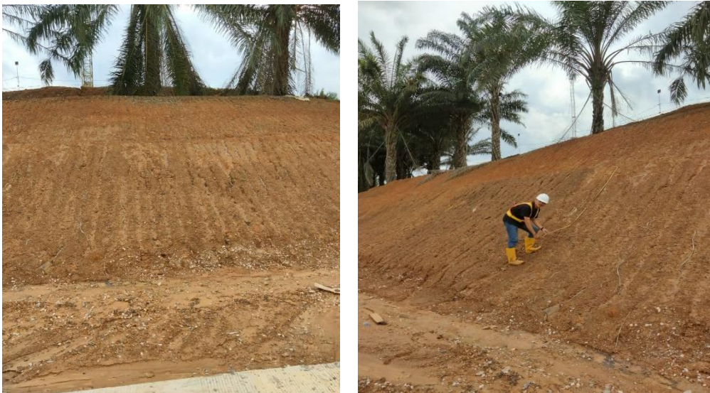
Gambar 1. Kondisi lereng akibat penggalian tanah (dokumen pribadi)
