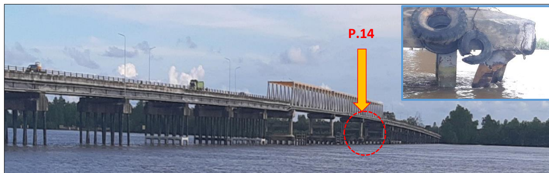
Gambar 2. Pondasi Mengalami Kerusakan
