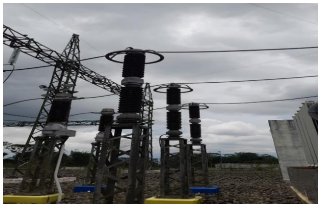
Gambar2. Tranformator Gardu Induk 150 Kv Temanggung
