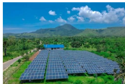
Gambar 1 Pembangkit Listrik Tenaga Surya (PLTS)
