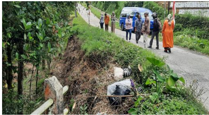
Gambar 1. Kondisi setelah terjadinya longsor
